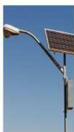
Postes Iluminação Solares
