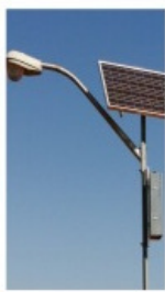
Postes Iluminação Solares
